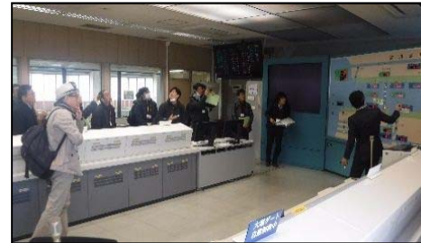
毛馬排水機場
