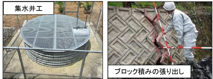
地すべり対策施設の整備
