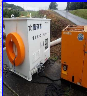
下万呂地区設置場所
