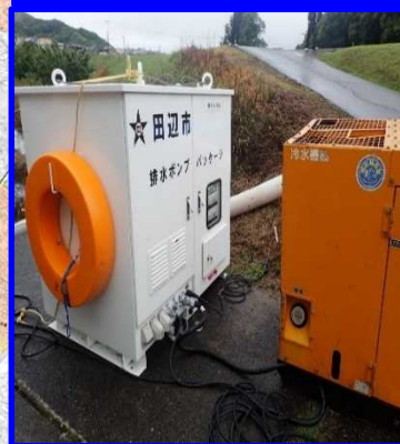
下万呂地区設置場所
