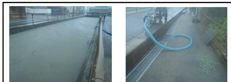
稼働時況(出水時)
