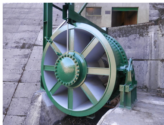
放流設備整備更新状況
