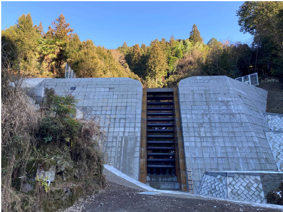
【フケ小路谷川砂防工事（かつらぎ町花園梁瀬 令和6年2月完成）】
