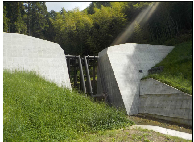
【砂防えん堤整備状況】
