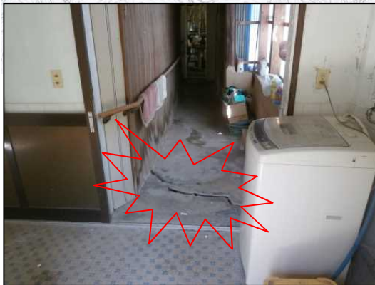
(土間コンひび割れ)
