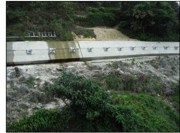
地すべり対策施設の整備
