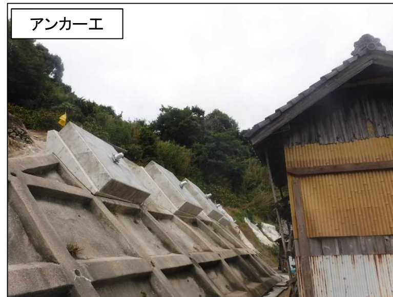
地すべり対策施設の整備
