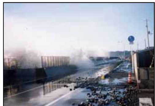
台風で越波する国道42号
