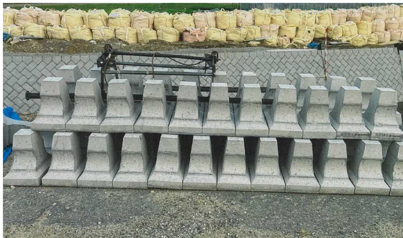
事故発生時の間知ブロックの仮置き状況 (2段積み)
