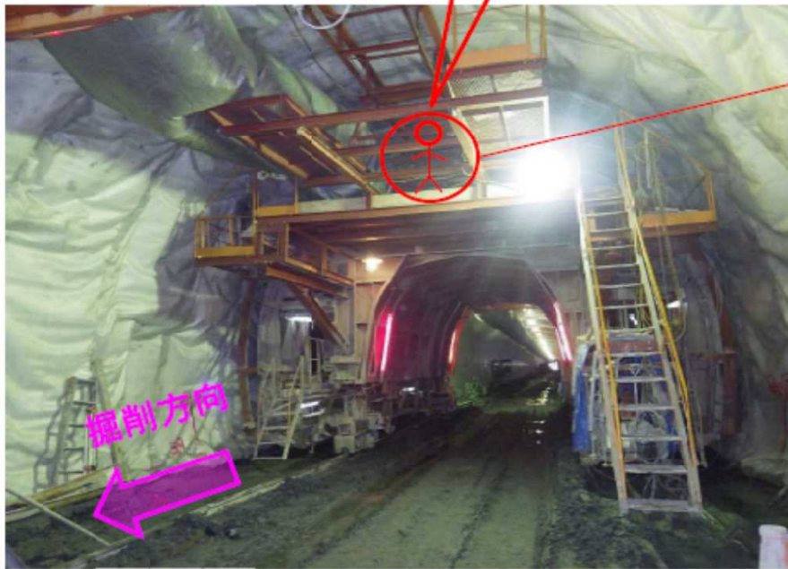
被災状況箇所全景
