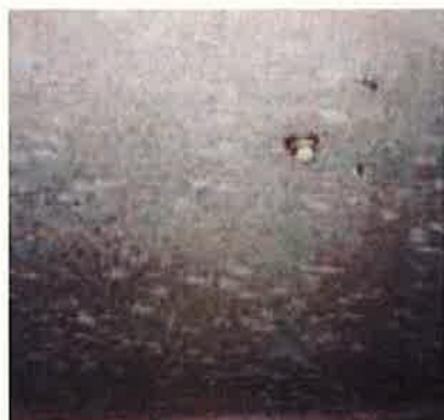
吸音・断熱材（機械室の壁・天井）
