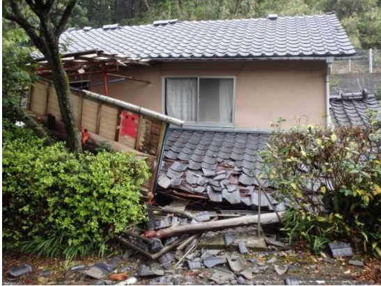
熊本地震の被災家屋（西原村）
