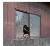
窓が割れた管理不全空家
