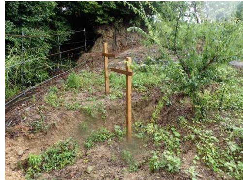
写真-1 斜面頂部での変状 (立平地区)
