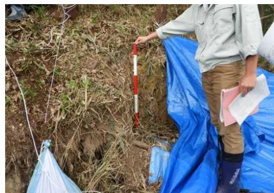
写真-2 斜面頂部での変状（有功地区）
