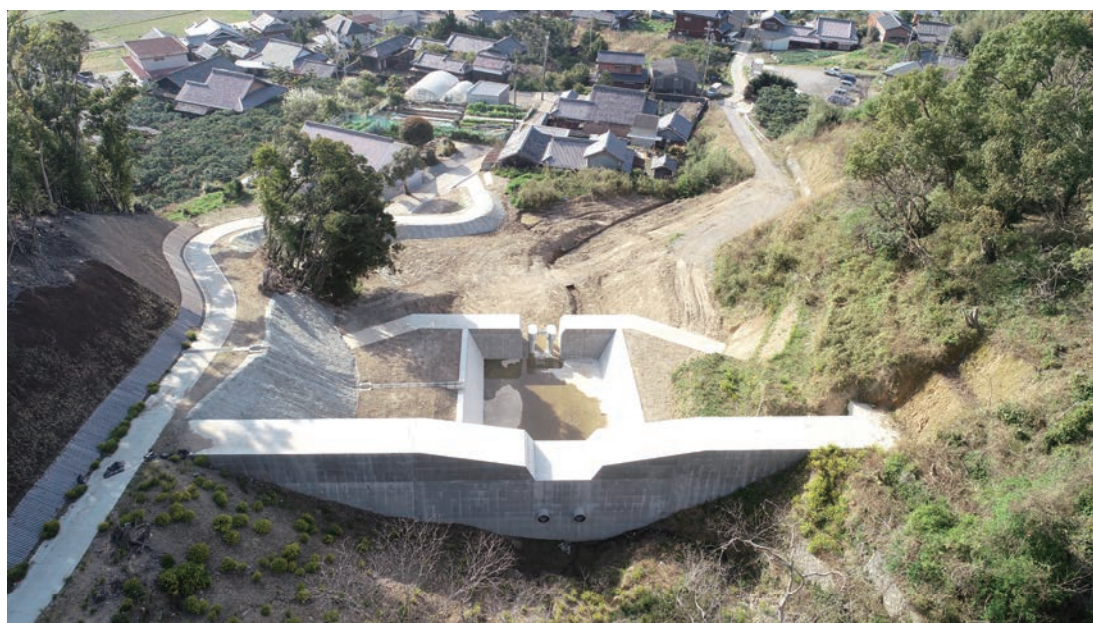
三又谷川（日高町高家）不透過型えん堤
