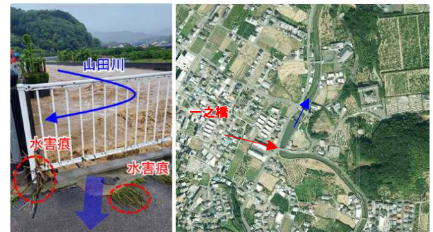
R5.6豪雨で氾濫した一之橋付近
