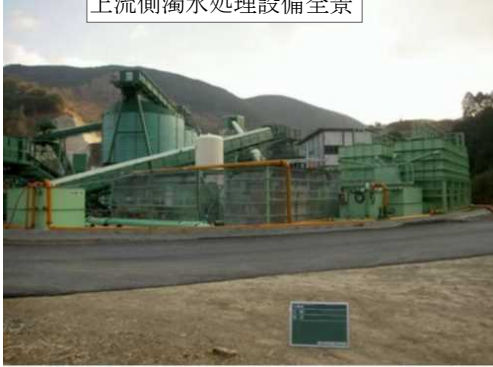
上流側濁水処理設備全景
