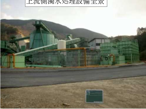
上流側濁水処理設備全景
