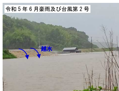
西川（越水の様子）志賀川合流部下流
