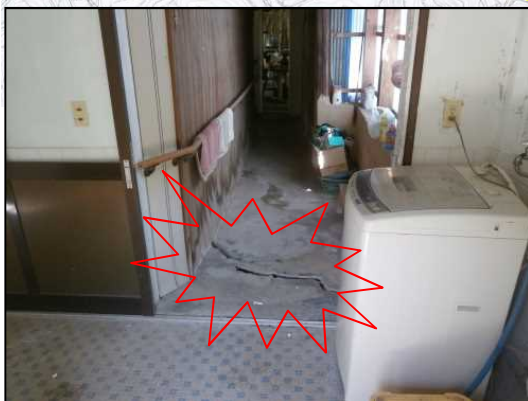
(土間コンひび割れ)
