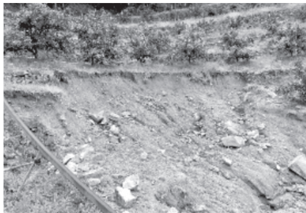
大雨による園地の崩落
