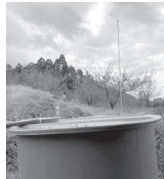
スプリンクラー設備
