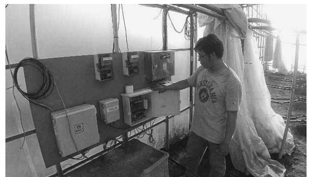
ハウス内環境の制御盤
