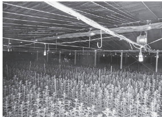
写真2 多層断熱被覆資材を設置したハウス（閉めた状態）
