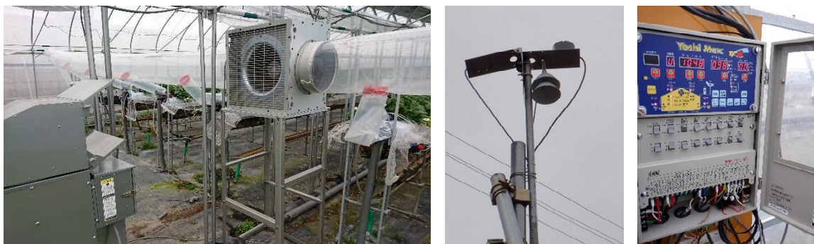
実証ほ予定ハウス（左から CO 2 局所施用装置、外部環境センサー、複合環境制御装置）
