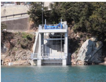
取水ゲートの遠隔操作
