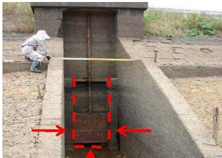
写真 37：ゲート周りの漏水
