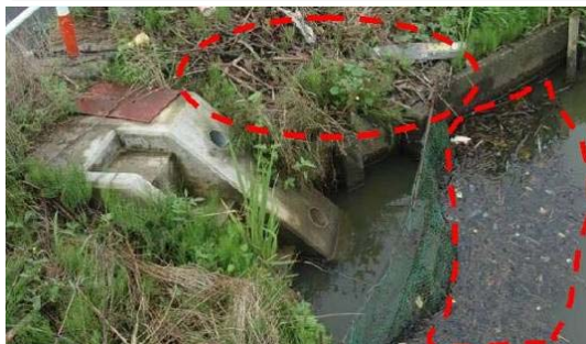
写真 38：取水部周辺の土砂やゴミの堆積
