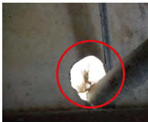
鶏舎壁面の隙間
