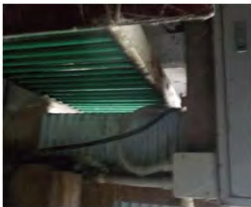
集卵ベルトの鶏舎外開口部の隙間
