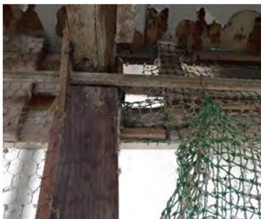
家きん舎内壁の防鳥ネットの隙間
