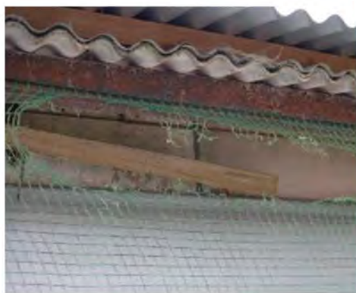
発生鶏舎の防鳥ネットの破損
