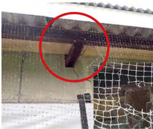
防鳥ネットの破損
