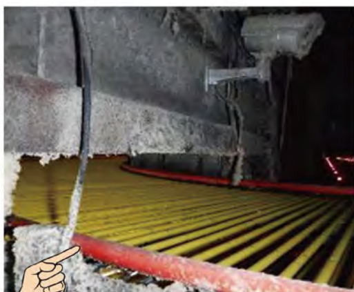
集卵バーコンベア鶏舎開口部の隙間
