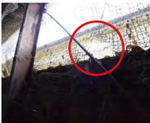
カーテン及び金網の破損
