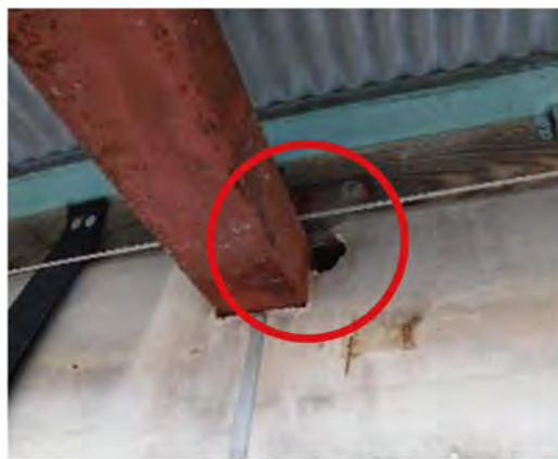
発生鶏舎壁面の空隙
