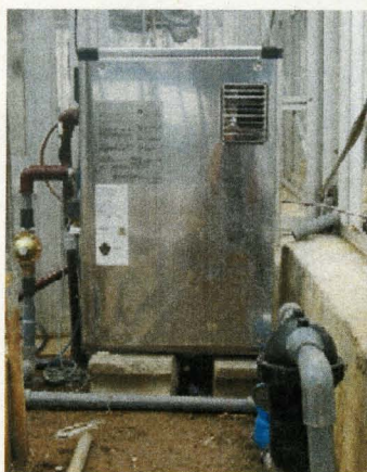
写真 石油小型給湯器
