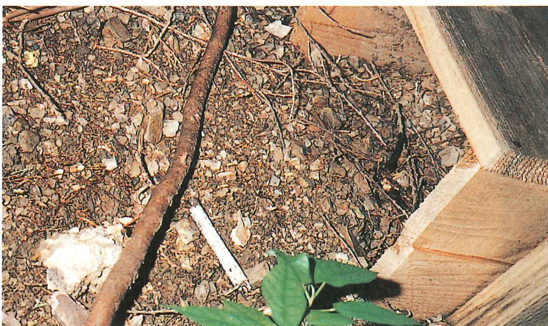
写真-18 土砂受け箱に溜まった流亡土壌
