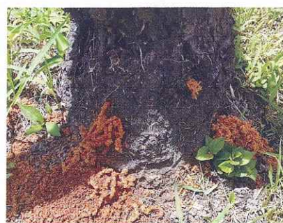
株元から排出されたミンチ状のフラス
