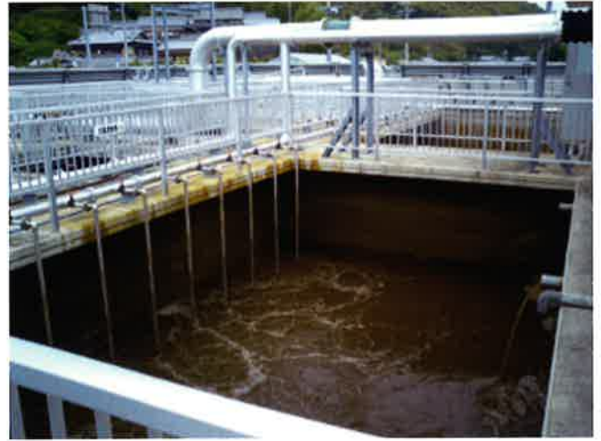
梅調味廃液の処理槽の様子
