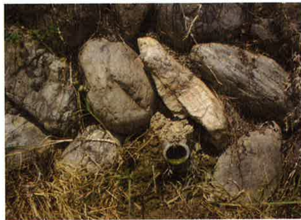
写真4-2 雨がなくても少しずつ排水されている
