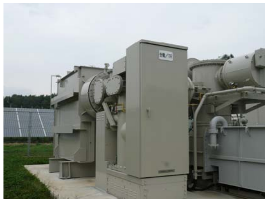
図 4.6.2-12 GIS・特高トランス(変電所内)
