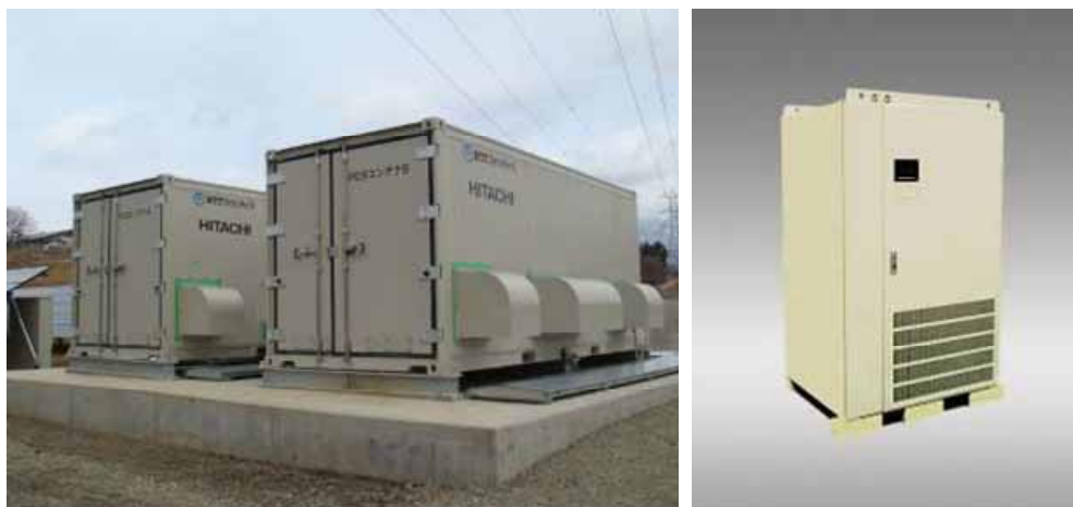
図2.4-1 大容量PCSの外観（左：コンテナ、右：本体）
