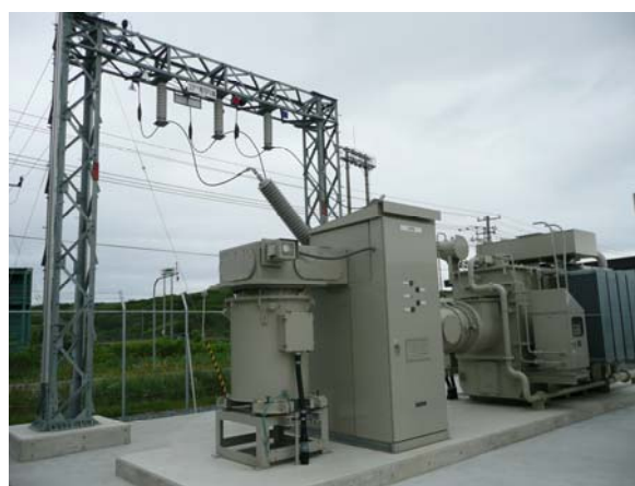
図 4.6.1-11 33kV 特別高圧受電設備
