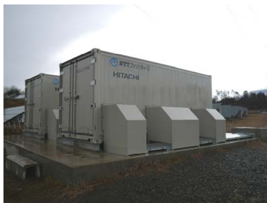
図 4.6.2-14 400kWPCS用コンテナ
