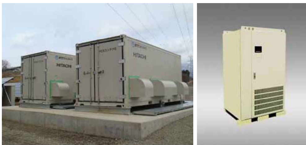
図 1.3.2-3 大容量 PCS の外観 ( 左 : コンテナ、右 : 本体 )
