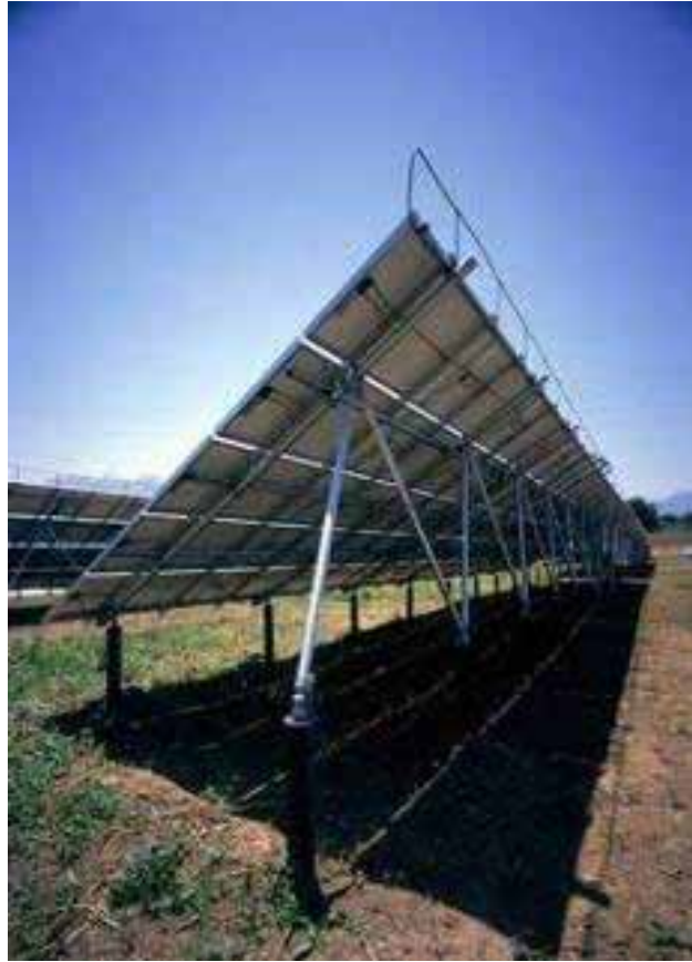
図 1.3.2-7 北杜サイトで開発した先進的架台
