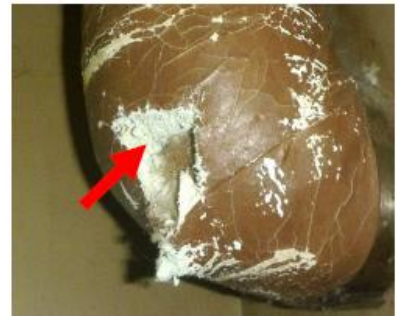
保温材の露出
