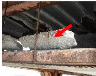
落下した吹付け材
