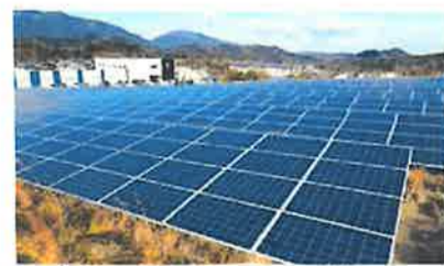
太陽光発電所
