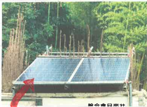
太陽光パネル
