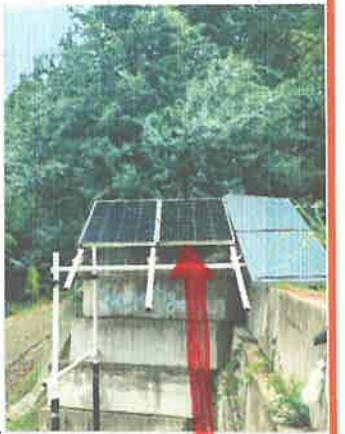
太陽光パネル
