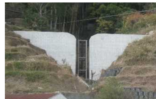
萩の谷川（田辺市）＜砂防堰堤＞
