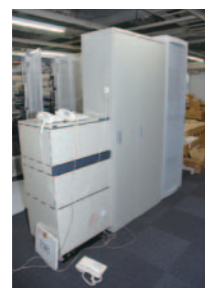
I P防災中継交換機他
