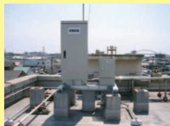
非常用発電機
