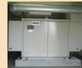
非常用発電機
