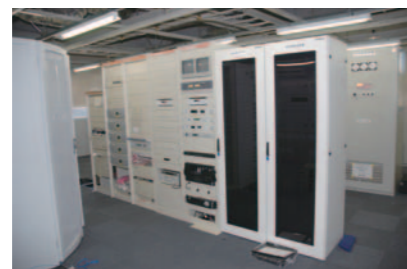
衛星端局装置、全県移動制御装置他
