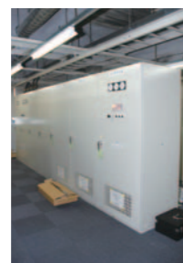
直流電源装置
