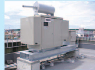
非常用発電機
