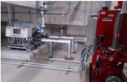
① 雨水ろ過装置
