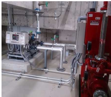
① 雨水ろ過装置
