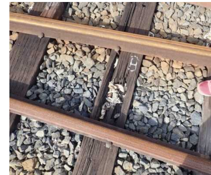
老朽化した線路の枕木
