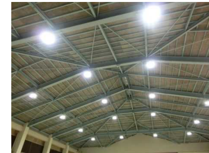
体育館のLED照明
