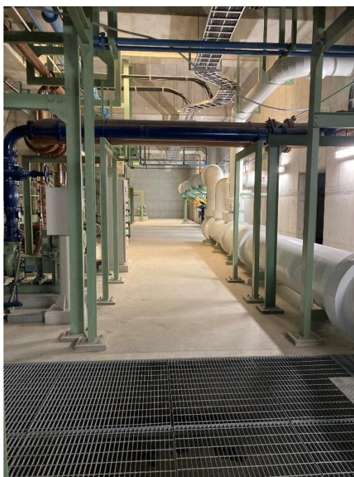
【塩素混和施設】
