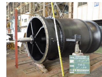
整備後の排水機
